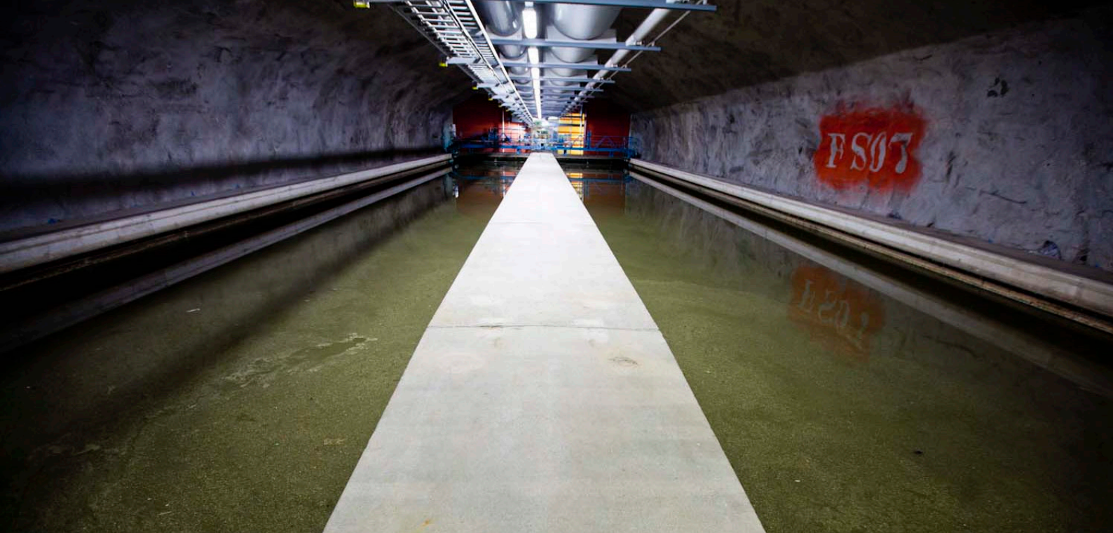
Försedimenteringen i reningsverket (Foto: Käppalaförbundet)
